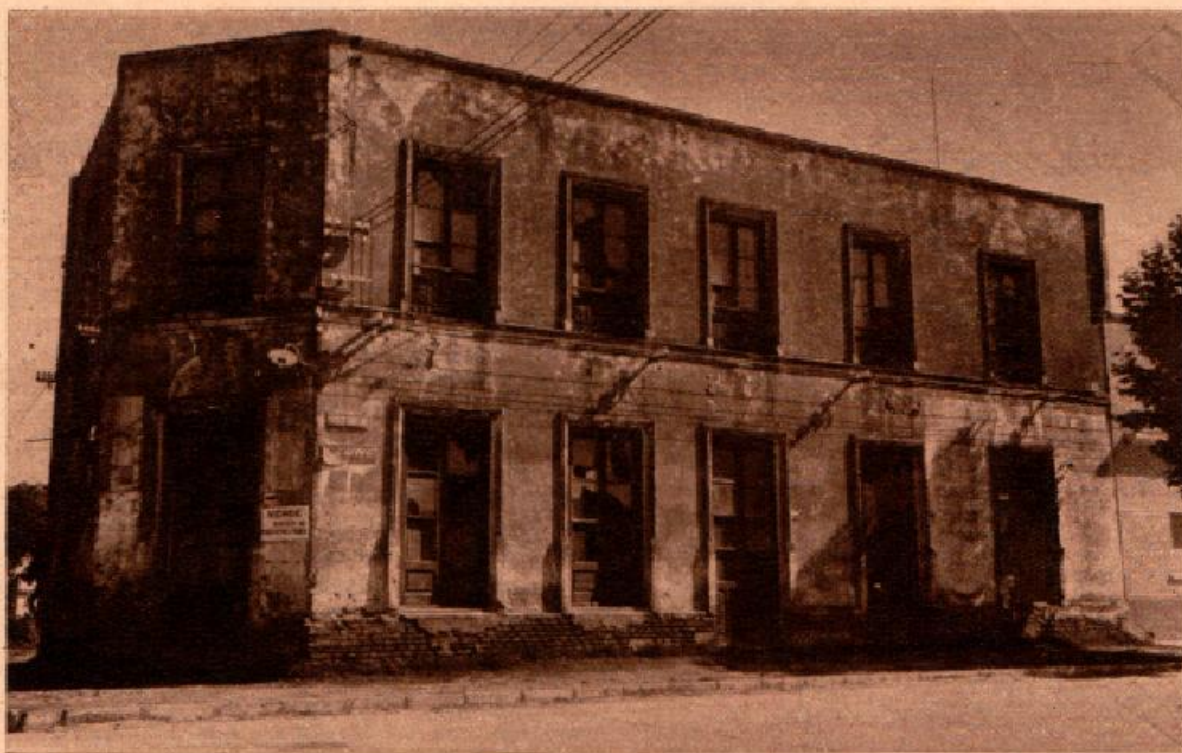
Lo que va quedando (si ya queda) de aquella gran construcción que dio alojamiento a la Escuela Nº 25, entonces llamada "Dej altillo" y dirigida por doña Ema da Rosa. (Foto De Grandi)
